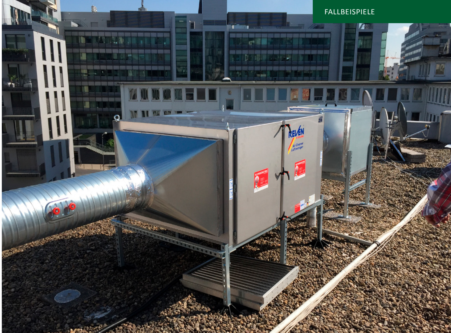
Fertig installierter Kanalabscheider und Ventilator in dem Fortluftstrang des Thai-Restaurant Aroydee auf dem Dach
