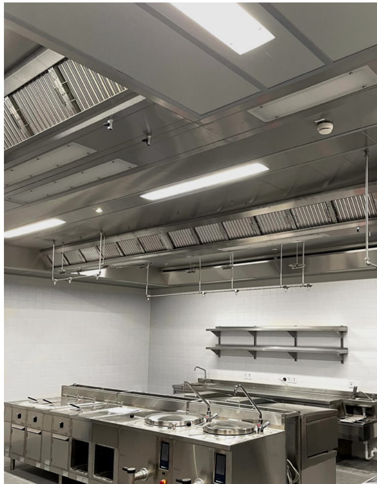
Küchenlüftungsdecke mit RSC-Steuerung und Feuerlöschanlage
