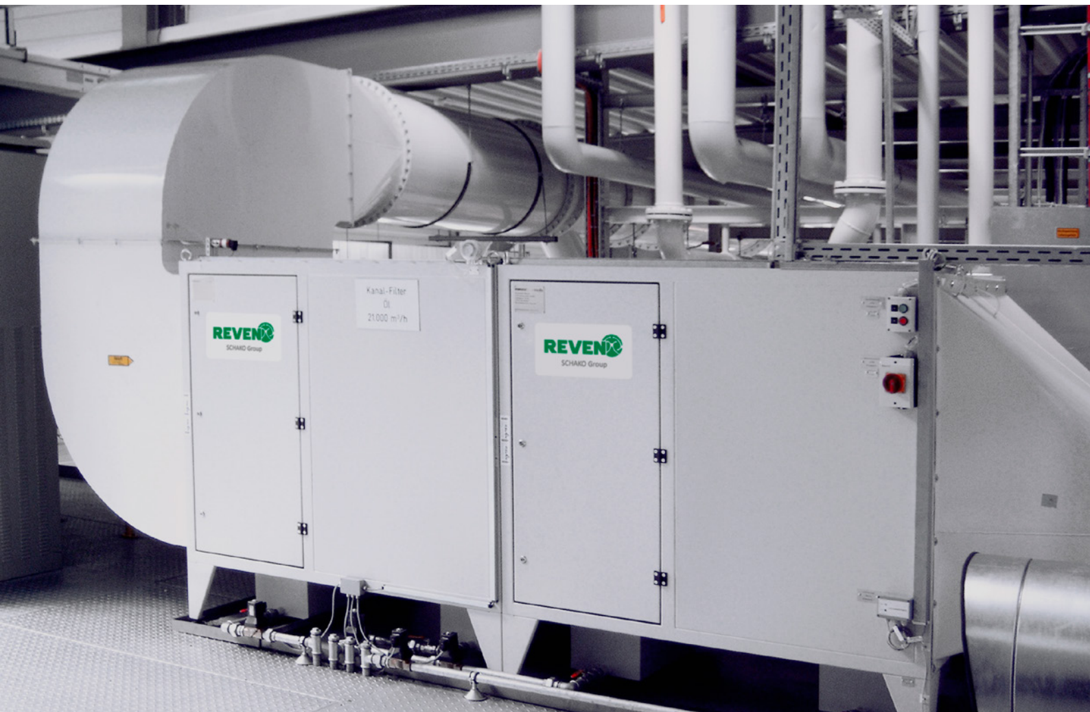
Zwei hintereinander geschaltete X-CYCLONE® RKM Abluftkanalreiniger
