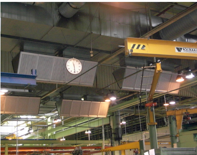
Hallenlüftung mit Erfassungsmodulen der X-CYCLONE® E2S-Serie
