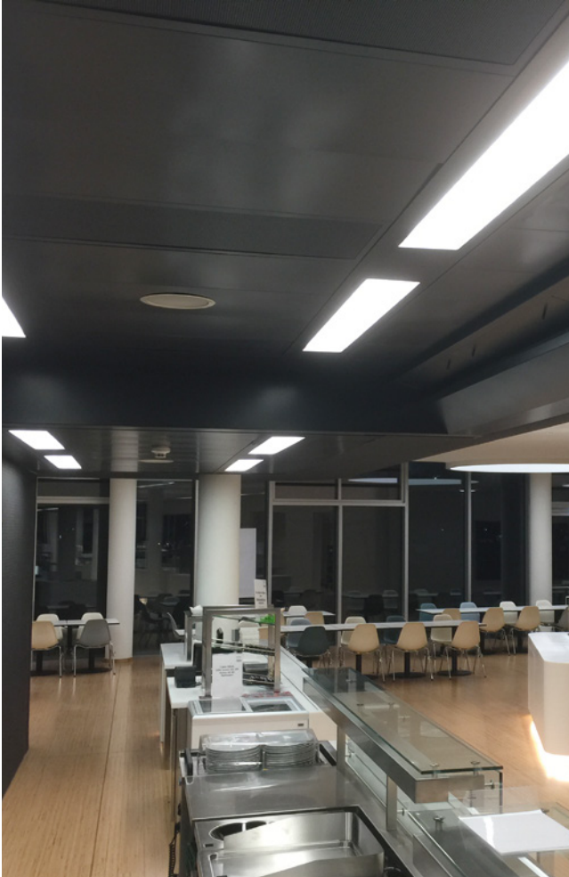
Schwarze Lüftungsdecke in einer Kantine
