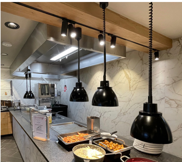
Einzelne Küchenhaube im Ausgabenbereich
