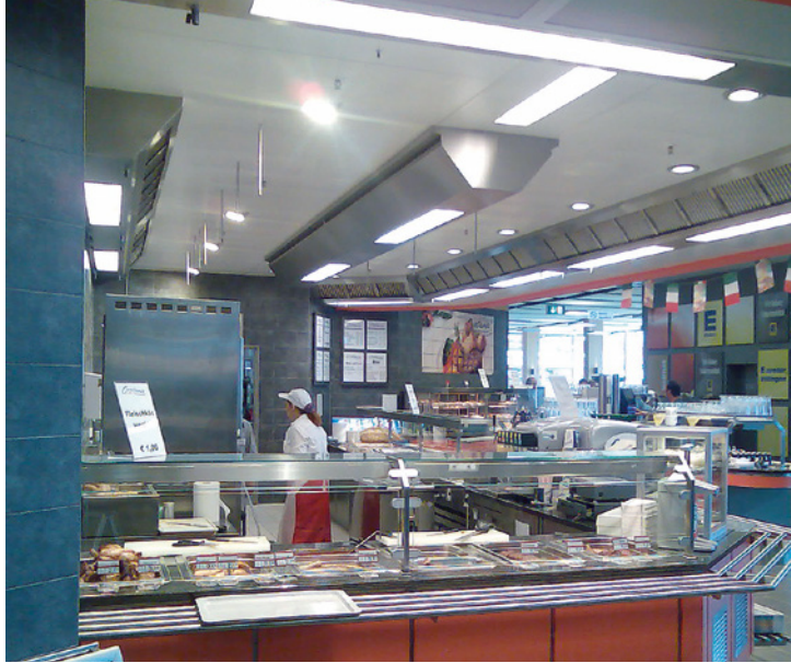
Lüftungsdecke für Kantinenangebot
