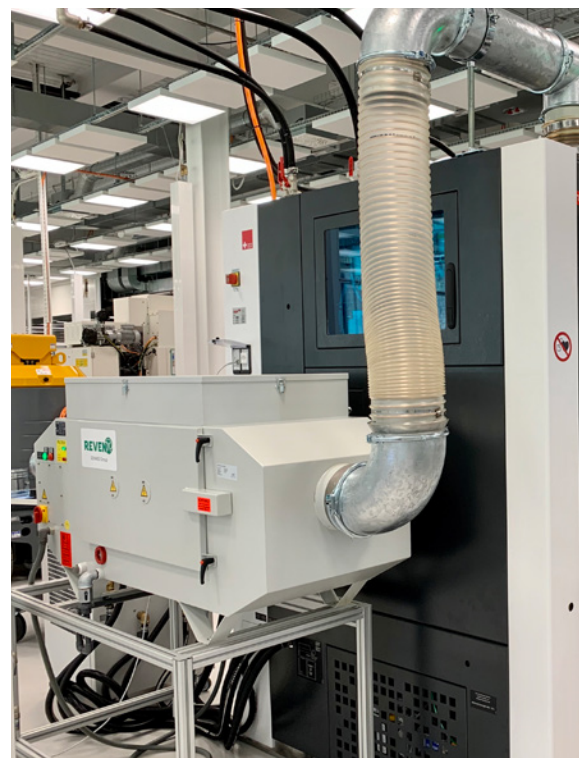
Ölnebelabscheider mit Rückführung des Kühlmittels
