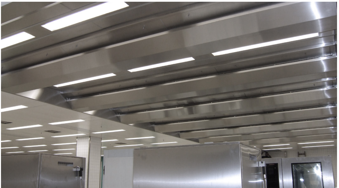
Abb.: Lüftungsdecke mit Abluft-Deckenmodulen X-CYCLONE® DR und Zuluftinduktions-Deckenmodulen REVEN® DVN und in die Deckenwand eingelassenen REVEN® Energiesparsensoren.
