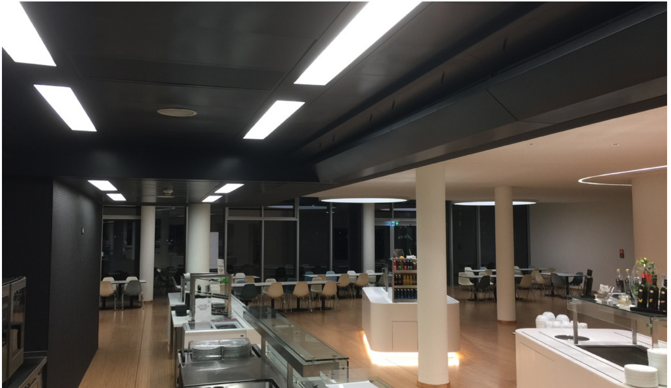
Abb.: Geschwätzte REVEN Küchendecke mit RESEX® Spühsystem in der Kantine des Deutschen Zentrums für Neurodegenerative Erkrankungen
