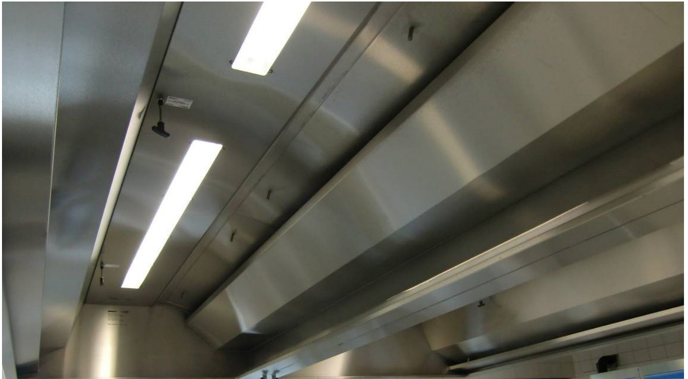
Abb.: Erfassungssystem Küchenablufthaube X-CYCLONE® EVNR als Mittelausführung links und ganz rechts hinten: REVEN® Induktionssystem; rechts vorne: die verdeckten Aerosolabscheider samt REVEX® Spühsystem, davor in die Deckenwand eingelassenen REVEN® Energiesparsensoren.
