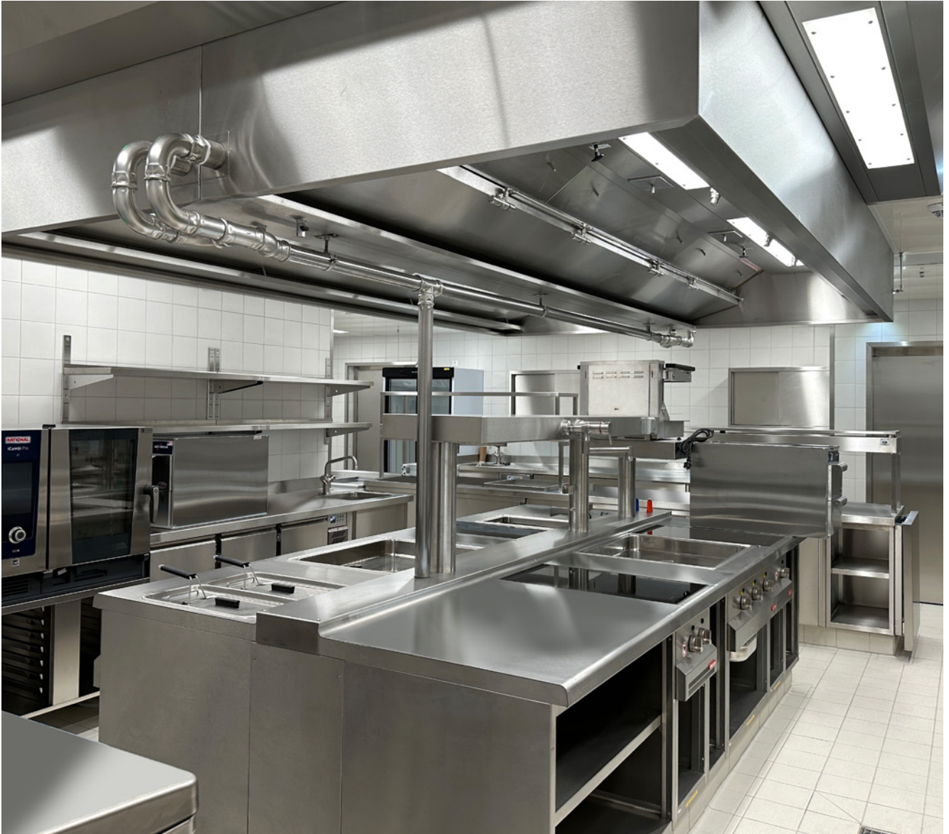
Abb.: Beispiel für Abwasserentsorgung mit formschönen Edelstahlrohren bei einer RESEX® Küchenhaube in einer gewerbliche Großküche kurz vor der Inbetriebnahme im „The Spin“ (ONE FORTY WEST) in Frankfurt, einem der modernsten Wolkenkratzer weltweit.
