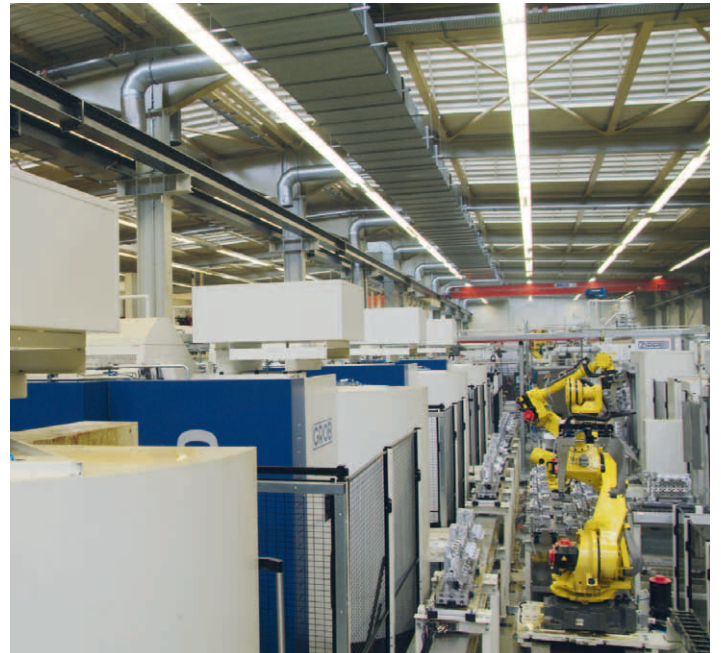
Bild 18 Dezentrale Absauganlage mit Einzelabscheidung
