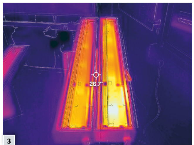
Der Messpunkt am Gehäuse zeigt eine Temperatur von 26,7 °C
